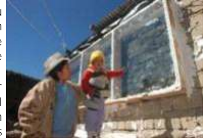
Muro Trombe instalado en Tuti – Arequipa- SENCICO
