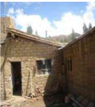
Vivienda sin sobre cimientado y con infiltraciones en encuentro de techo y muros
