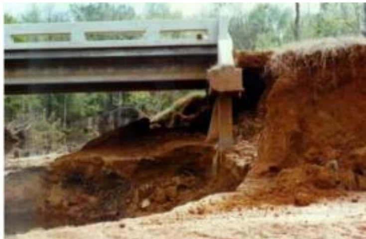
Figura 1: Erosión de la margen Fuente: Falero y Talero (2007)
