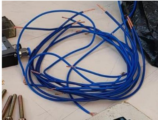
Figura 19: Cables para conexión
