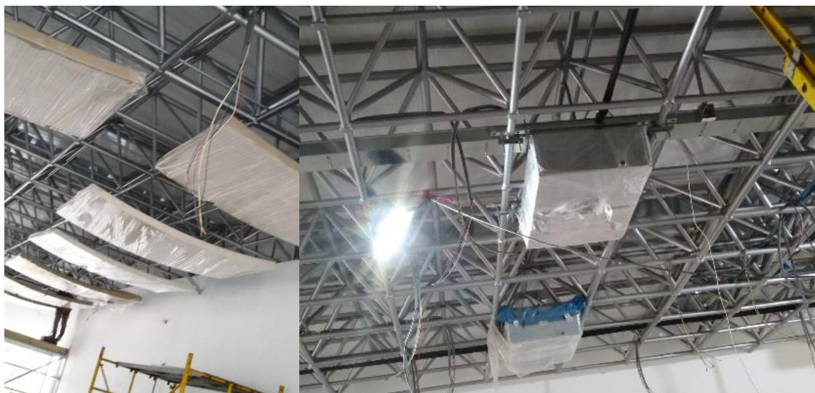
Imagen No.12: Paneles acústicos instalados. Elaboración propia.
