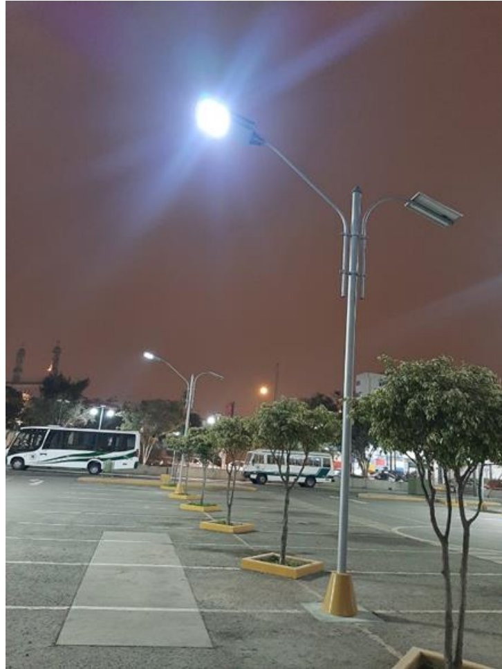
Imagen No.9: Pastorales de acero con luminarias fotovoltaicas (noche). Elaboración: Dr. Arq. Alejandro Gómez (Equipo Proyecto “Universidad Ecológica”)
