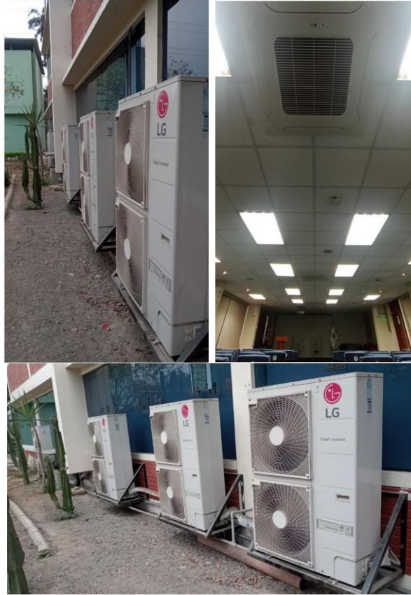
Uso de equipo de aire acondicionado INVERTER en el Auditorio de la Facultad de Arquitectura, Campus URP.
